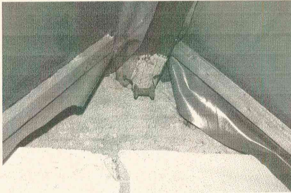
lose eingelegte „luftdichtende“ Folie ohne Dichtung an den Anschlüssen an die Giebelwand (im gleichen Haus im Spitzboden)
