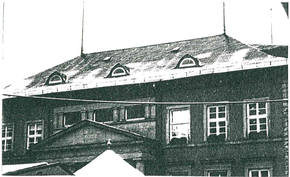
Dach des Rathauses: abgetaute Flächen an Dämmfehlstellen
